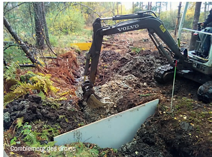
Mise en place de panneaux de bois pour étanchéifier le comblement des drains
